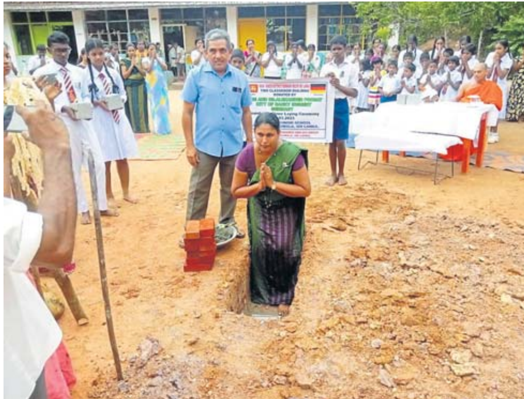
Unser Bild entstand bei der Grundsteinlegung für ein neues Schulgebäude der Kalawila-Junior-School durch die Schulleiterin Mrs. Hettiarachchi und den Koordinator der Hilfe für Beruwala, Mr. Irsan.
