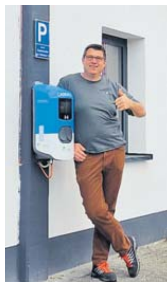
Andreas Rath präsentiert eine der E-Ladesäulen, die vor den Shops installiert wurden.
