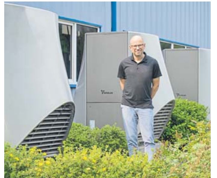
Markus Eckart möchte das Unternehmen Eckart Hydraulik mittelfristig klimaneutral aufstellen. Ein wichtiger Schritt war die vollständige Umstellung auf Wärmepumpen, die hier im Foto zu sehen sind. Foto: Eckart Hydraulik
