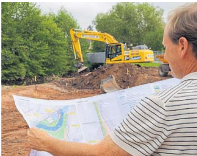
Thomas Müller vom Bauamt blickt auf die Pläne zur Umgestaltung der Kinzig hinter dem Feuerwehrgerätehaus, wo bereits die Bauarbeiten stattfinden. Foto: Stadt Schlüchtern
