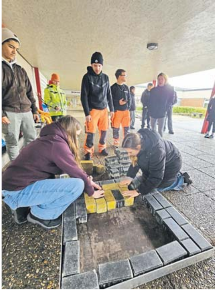
Junge Frauen , die Pflasterarbeiten erledigen. Das Straßenbauunternehmen Strassing GmbH ermöglichte diese Erfahrungen.
