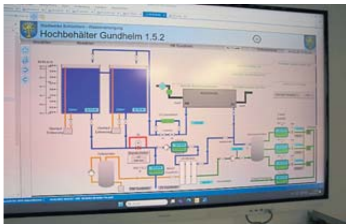
Mit viel technischem Aufwand wird die Wasserversorgung der Stadt Schlüchtern professionell gesteuert.
