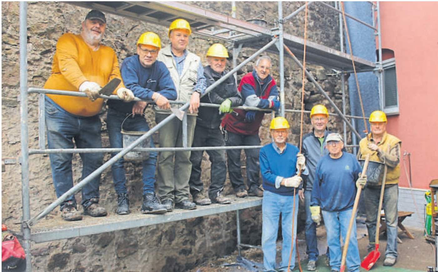
Etwa eine Woche sind die „Mauerspechte“ mit der Sanierung der historischen Stadtmauer im Hof der Familie Schmahl beschäftigt. Für ein Foto unterbrechen die Männer ihre Arbeit.
