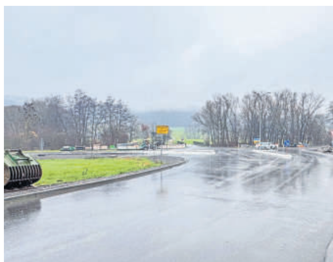
In Niederzell wird derzeit die Ortsdurchfahrt saniert. Der Festplatz wurde dort ebenfalls komplett neu errichtet.
