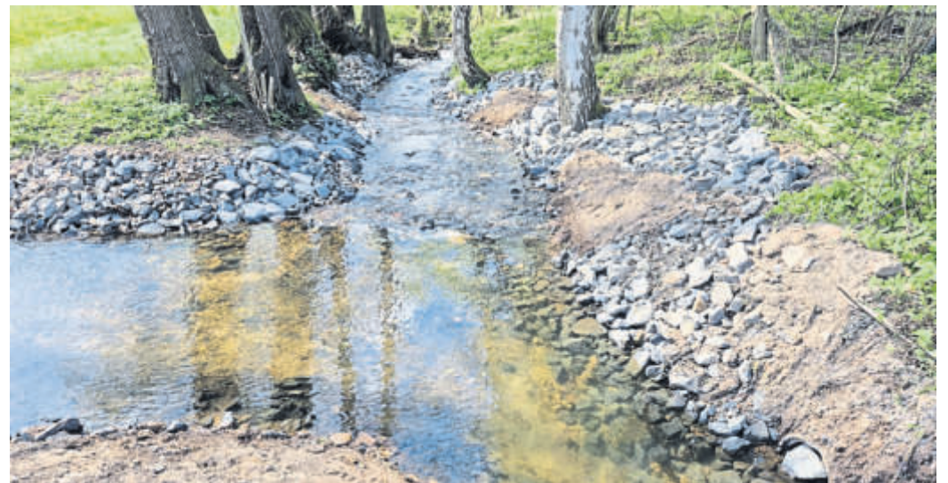
Am ehemaligen Wehr zur Hautzenmühle wurden drei Querbauwerke beziehungsweise Hindernisse im Gewässer beseitigt. Foto: Stadt Bad Soden-Salmünster
