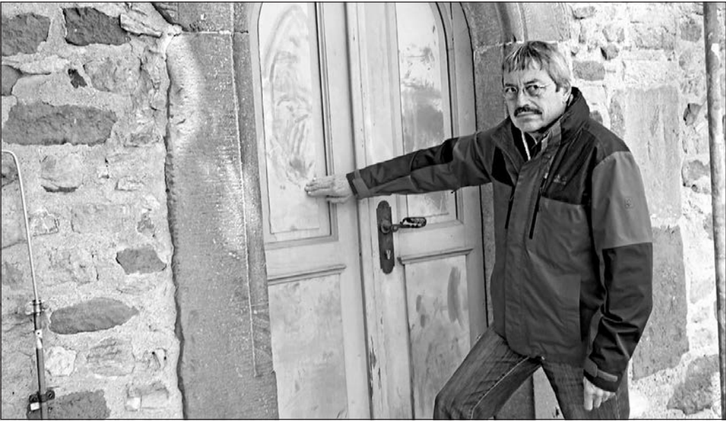
„Kirchenpate“ Rüdiger Voerste zeigt die Schäden am Südportal.
