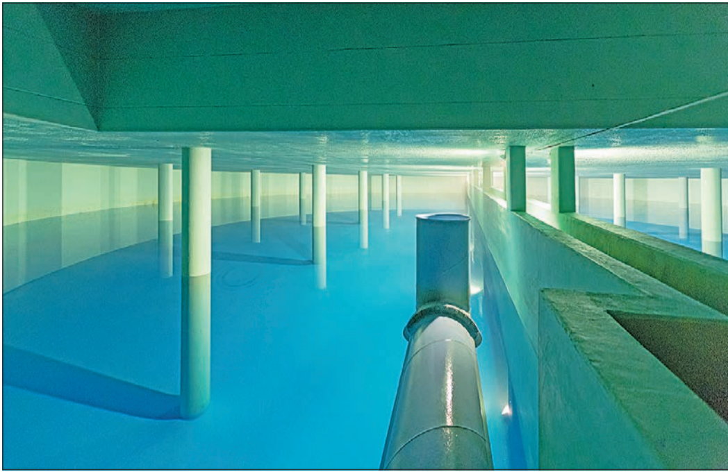
Am Borkenberg in Oberursel steht der größte Wasserhochbehälter des Versorgungsgebiets. Seine beiden 4,50 Meter tiefen Wasserkammern fassen mit insgesamt 14 Millionen Liter Wasser den zweifachen Tagesbedarf der Oberurseler Bevölkerung. Foto: Stadtwerke Oberursel
