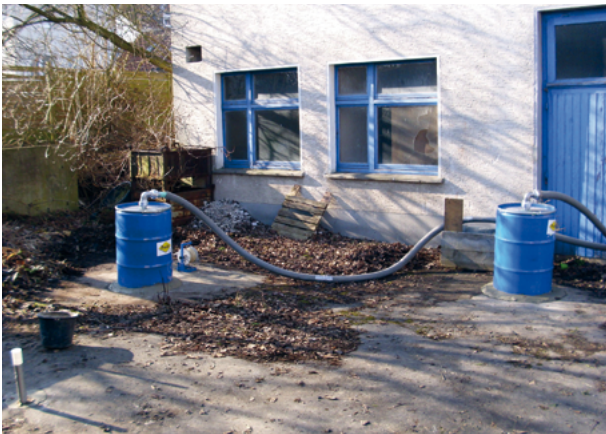
Abb. 4: Fallbeispiel 3 – ProAir-Absaugsysteme im Außenbereich
