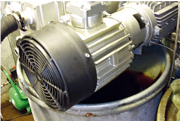
Abb. 7: Fallbeispiel 4 – Ölverlust an einem Hochdruckventilator
