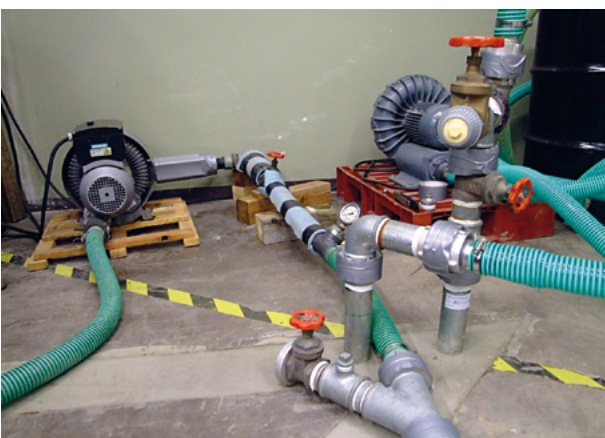
Abb. 9: Fallbeispiel 5 – Thermische Bodenluftabsaugung
