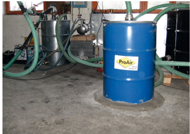
Abb. 5: Fallbeispiel 3 – ProAir-Absaugsysteme und Anlagentechnik im Gebäude
