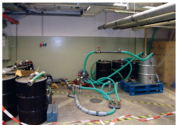
Abb. 10: Fallbeispiel 5 – Thermische Bodenluftabsaugung
