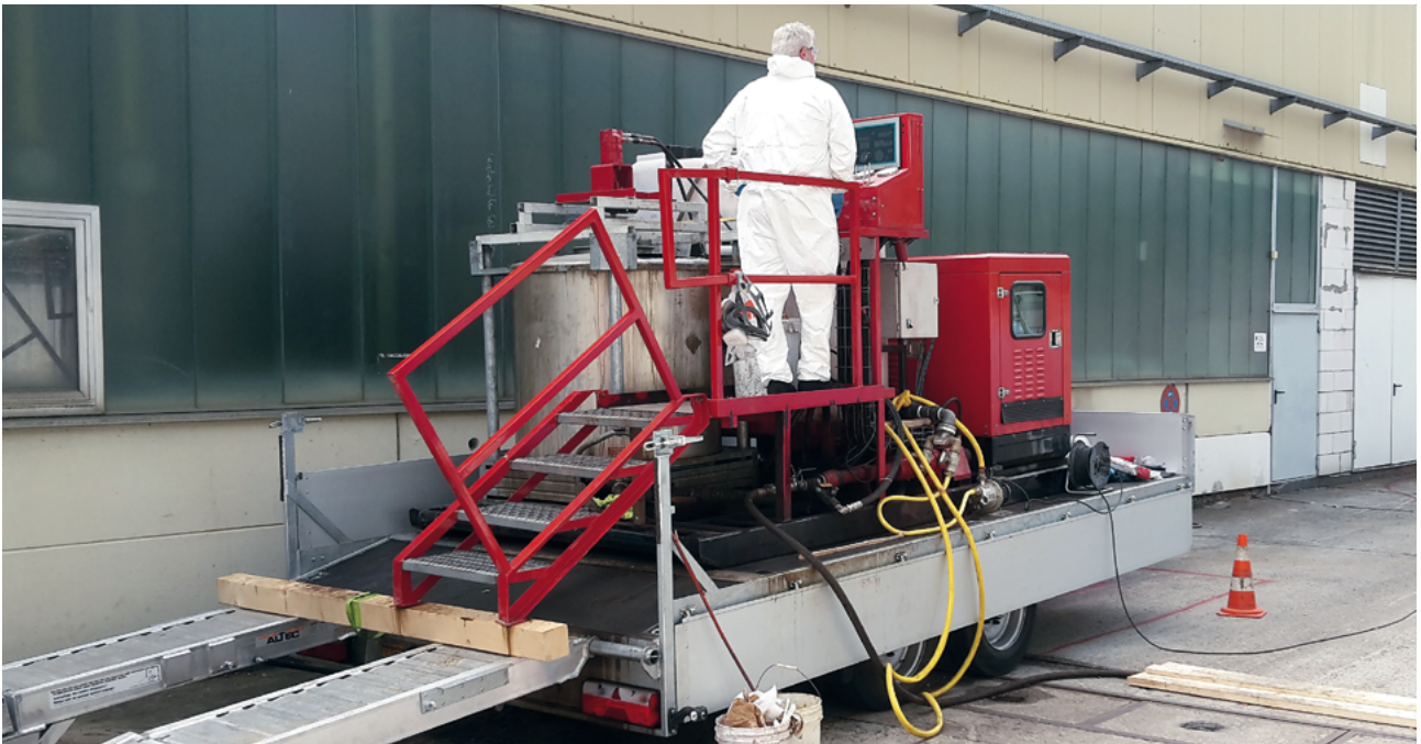
Abb. 2: Pump- und Mischanlage während des Pilotversuches
