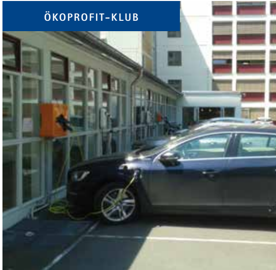
Ausbau Ladeinfrastruktur Wiesbadener Bürostandort „Unter den Eichen 7“
