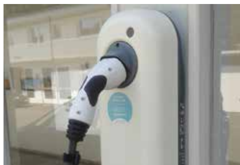
Neue Wallbox am Wiesbadener Bürostandort „Unter den Eichen 7“
