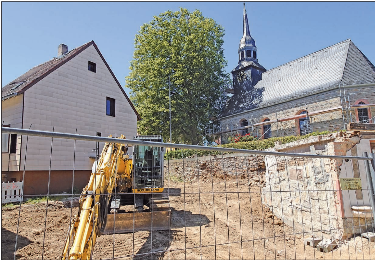
Nach dem Abbruch der alten Scheune in der Bornhohl ist der Blick auf die St.-Georgs-Kirche frei. Das Haus Kirchgasse 3 (links) soll abgerissen und damit der Kirchplatz erweitert werden. Foto: HB
