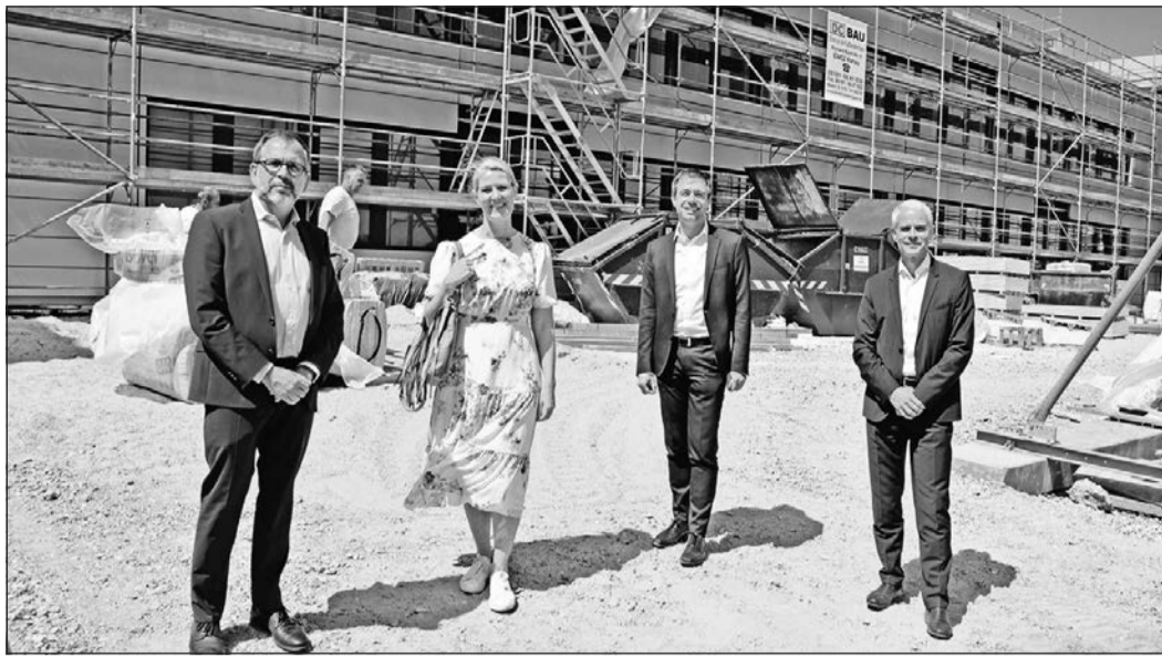
Ralph Gumb, Susanne Hemmersbach, Steffen Bonk und Maik Müller (v. l.) zeigen sich an der Baustelle zufrieden mit dem Baufortschritt. Foto: SiebersPartner GmbH & Co. KG
