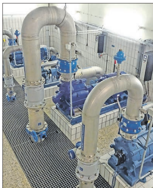
In der Pumpstation am Beginn des Steinbacher Netzes fließen täglich bis zu 1300 Kubikmeter Wasser in das 47,5 Kilometer lange Wasserleitungsnetz der Stadt. Foto: HB
