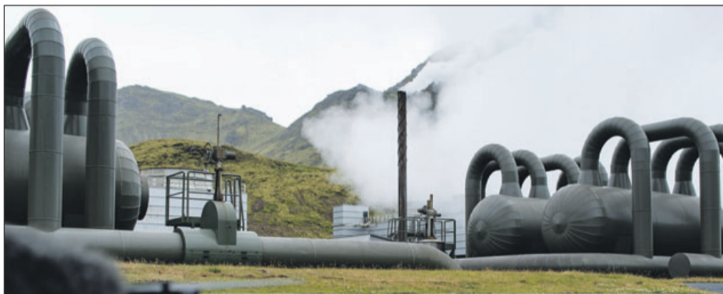
Das Geothermalkraftwerk Hellisheiði in Island. Ziel des Projekts ist es, CO 2 (Kohlendioxid) dauerhaft in Gestein zu binden. Foto: ZDF/Jan Prillwitz
