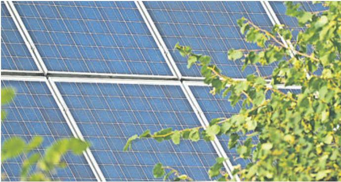
Photovoltaikanlagen müssen nicht immer - wie hier - auf Dächern angebracht werden. Kleinere Systeme lassen sich auch auf Balkon oder Terrasse installieren.
