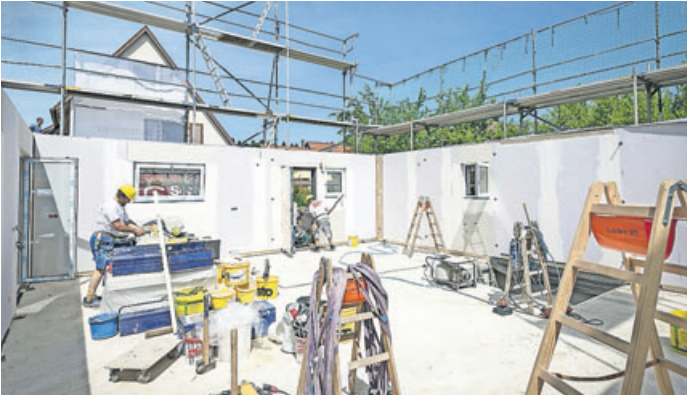
Baufirmen lassen sich gerne das Hausrecht am Baugrundstück geben - damit könnte aber der Bauherr seinen Zugang verlieren.
