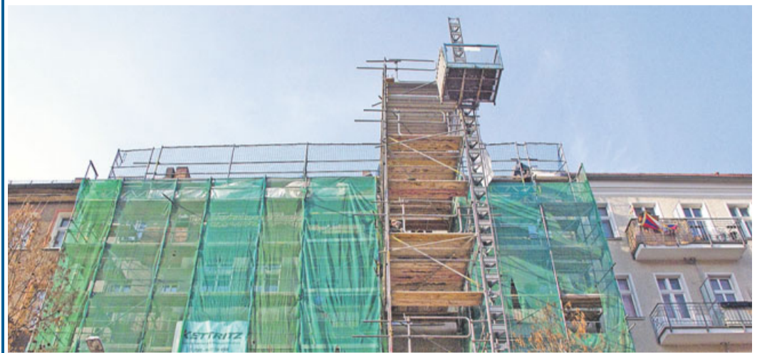
In der Teilungserklärung einer Wohnungseigentümergeinschaft wird auch geregelt, in wel-chem Umfang sich ein Eigentümer an Instandhaltungskosten für die Fassade beteiligen muss. Foto: Andrea Warnecke/dpa-mag
