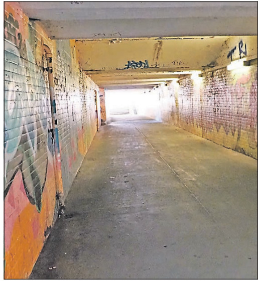
2008 wurde die Unterführung gereinigt, gestrichen und mit Friedrichsdorfer Motiven in hellen Farben gestaltet. Davon ist nichts mehr zu sehen. Foto: fch
