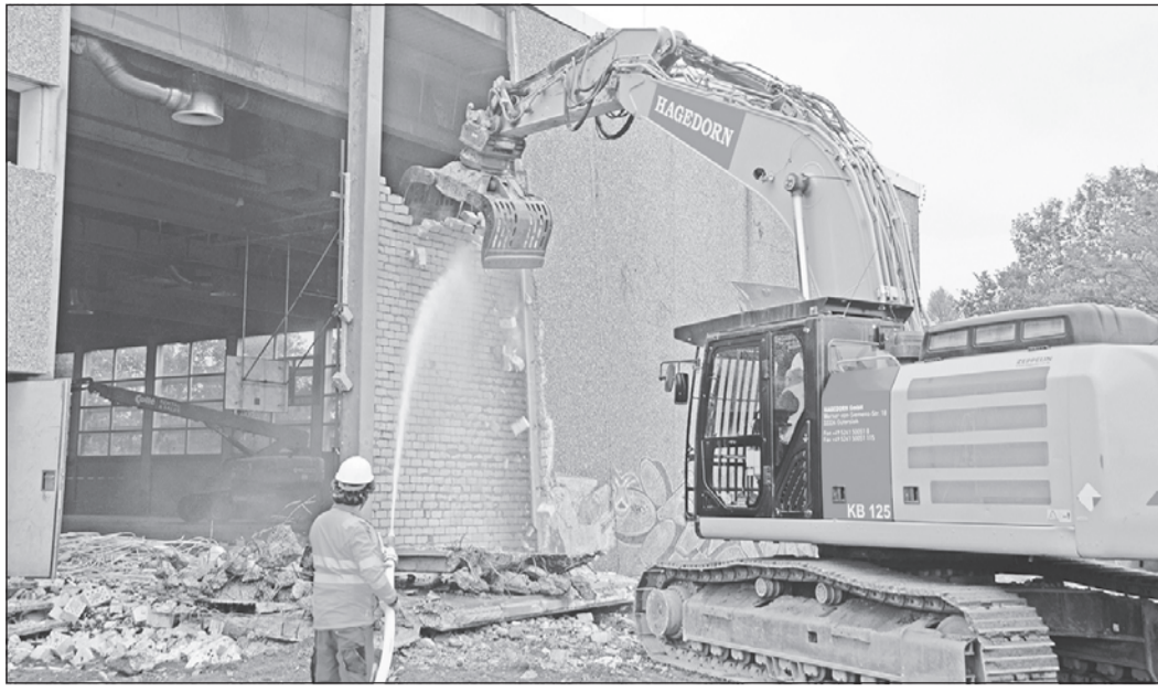
Der Abrissbagger frisst sich in die Kieselsteinverblendung der Rückwand der Albin-Göhring-Halle, knabbert sich Stück für Stück voran, bis die Wand in Teilstücken einbricht. Foto: js
