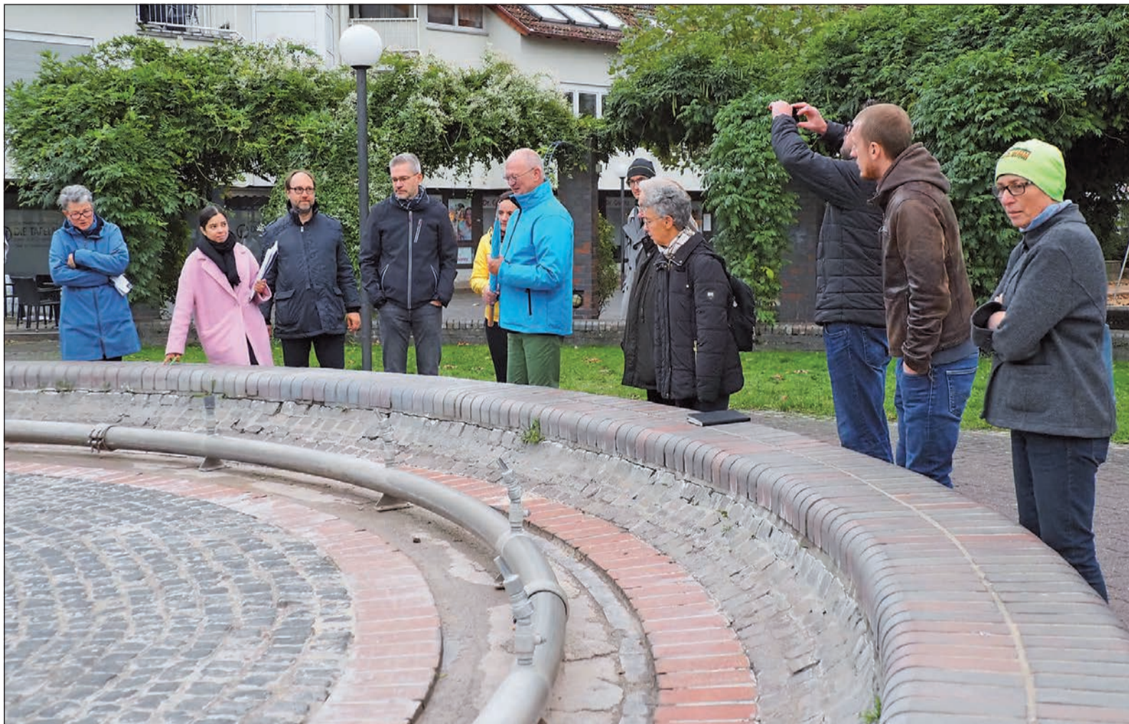
Der große Brunnen auf dem Houiller Platz ist marode und muss ersetzt werden. Eine Sanierung wäre zu teuer.
