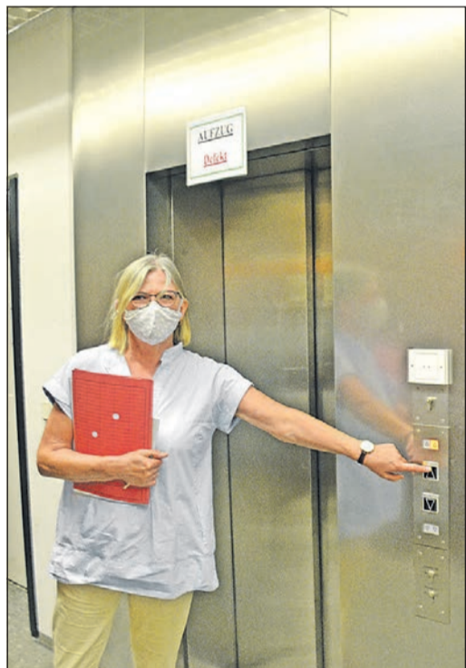
Mist, Aufzug schon wieder defekt. Lydia Hecker, Koordinatorin beim Sanierungskonzept, traut ohnehin mehr ihren Füßen als der veralteten Technik der Aufzüge. Foto: js
