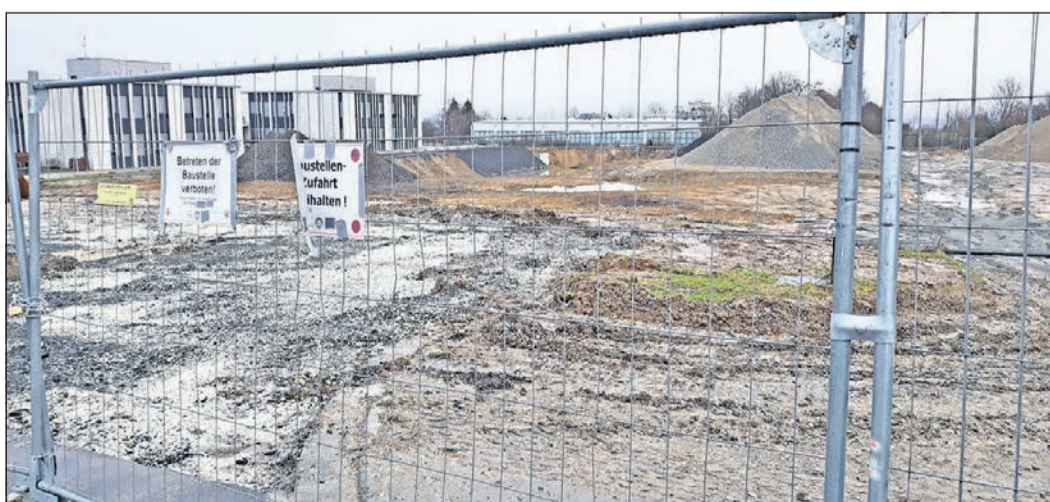
Hier stand sie einst, die stolze IGS, nach nur 50 Jahren ist es vorbei, derzeit werden die Reste des Schulgebäudes aus dem Jahr 1971 weggeräumt. Foto: js
