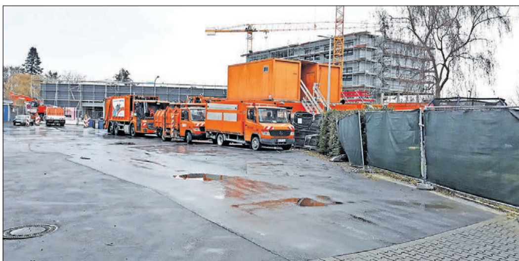
Der neue Wertstoffhof an der Oberurseler Straße wächst, es ist eines der vier Großprojekte, in das die Stadt in den kommenden Jahren eine zweistellige Millionensumme investieren muss. Aktuell wird mit Baukosten von rund 13 Millionen Euro für den Umbau der nicht mehr zeitgemäßen Anlage kalkuliert. Foto: js
