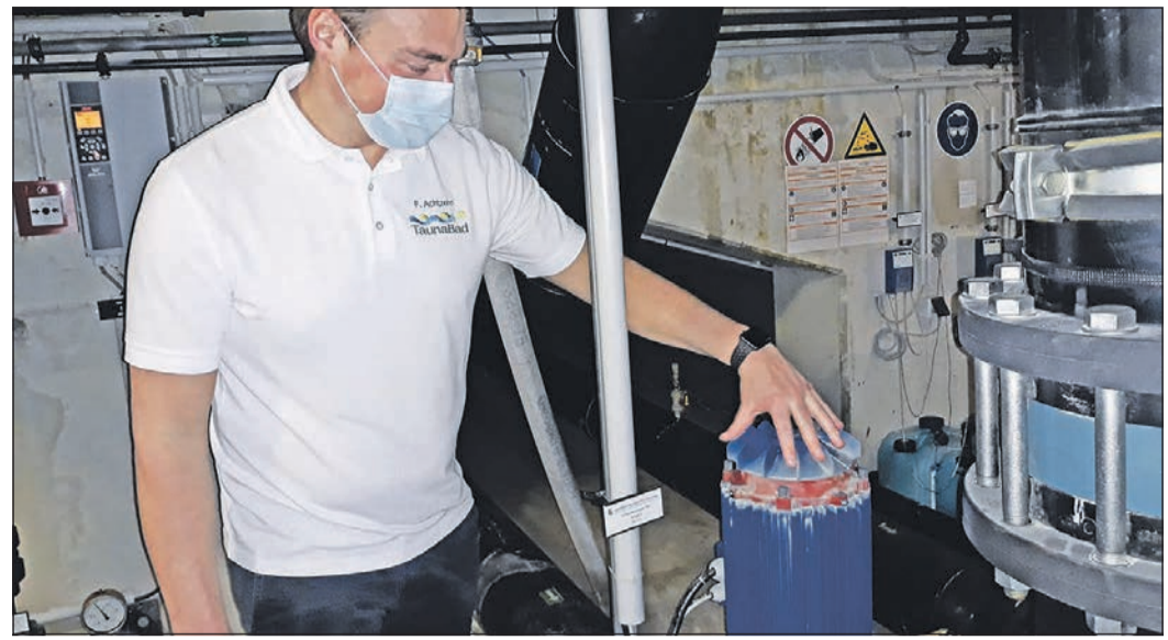
Frank Achtzehn allein zu Hause: Oft ist der Betriebsleiter allein im großen Taunabad, dreht mit der Hand an einer Pumpe, kontrolliert die Becken und die Duschräume. Foto: js
