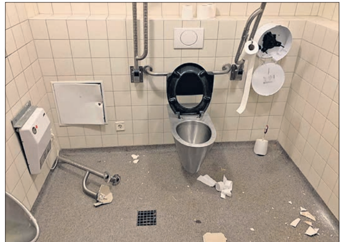
Mutwillige Beschädigung führt zur Schließung der Bahnhofstoiletten.
