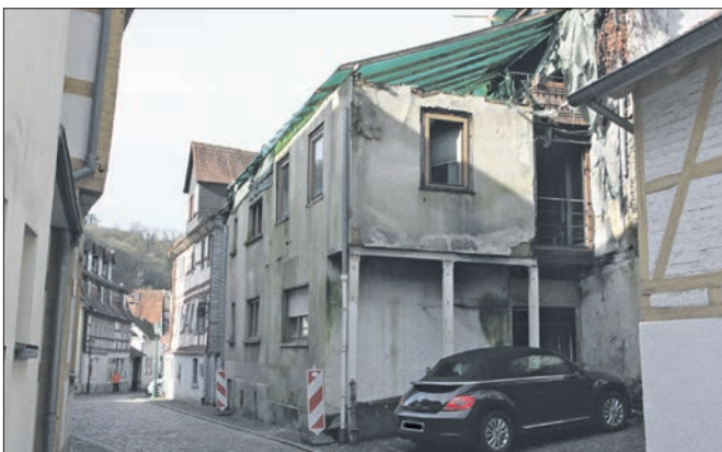
Die Bauruine in der Burgstraße 60.
