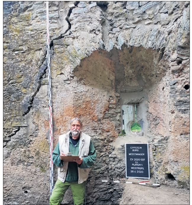
Joachim Zeune mit seinen Aufzeichnungen vor der 2004 freigelegten Schießscharte, über der sich ein tiefer Riss durchs Mauerwerk zieht. Foto: Naemi Zeune
