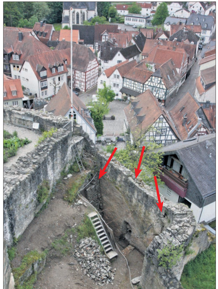
Ein Blick in den Westzwinger: Dessen Mauer wurde freigelegt, um drei Risse zu untersuchen: Ein tiefer Riss im Pfeiler am südlichen Mauerende, einer über der Türöffnung und einer am nördlichen Ende. Foto: bpa
