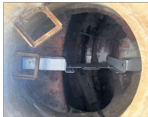
Neue Technik im Kanalschacht: Abflussbremsen sollen in Bremthal tiefer liegende Bereiche vor Hochwasser schützen. Foto: Stadt Eppstein
