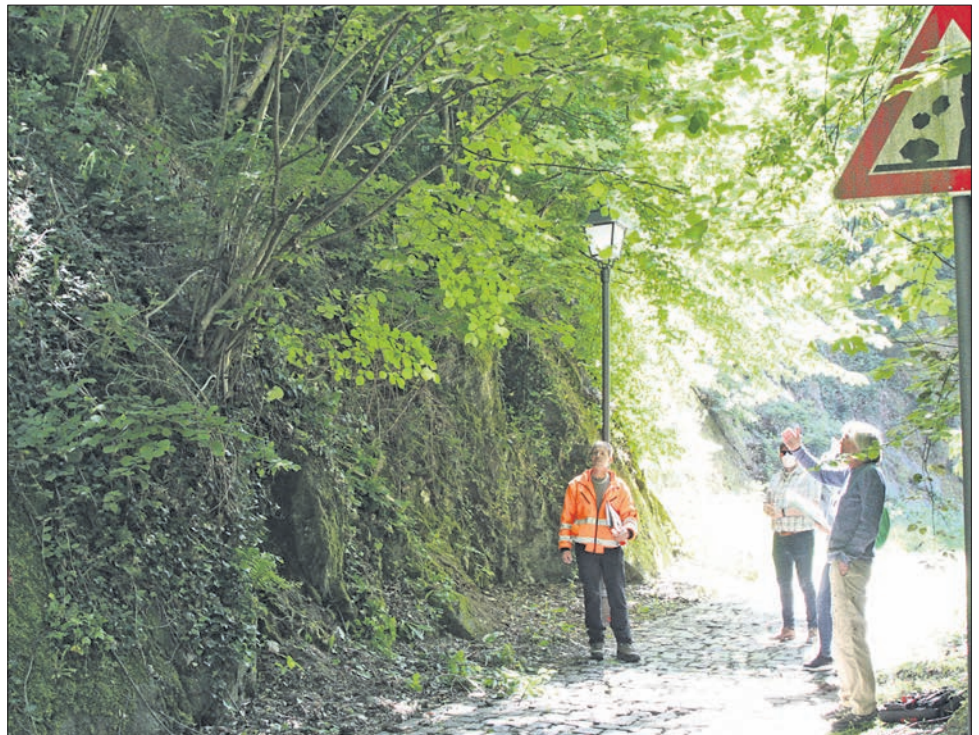
Stadtbauamt, Geologen und Naturschutzbehörde besichtigen den brüchigen Fels im Halsgraben.
