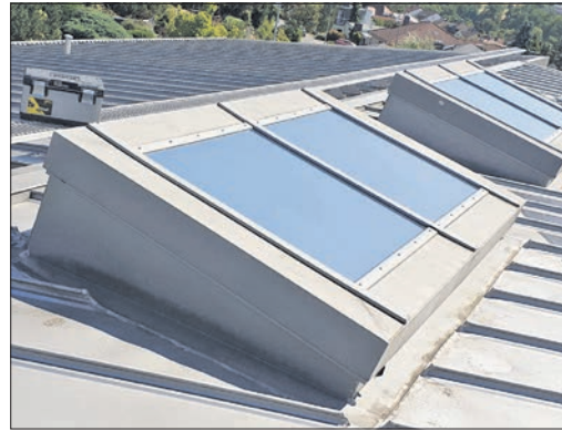
Die Oberlichter an der Kita Zwergenburg sind mit einer Sonnenschutzfolie versehen worden.
