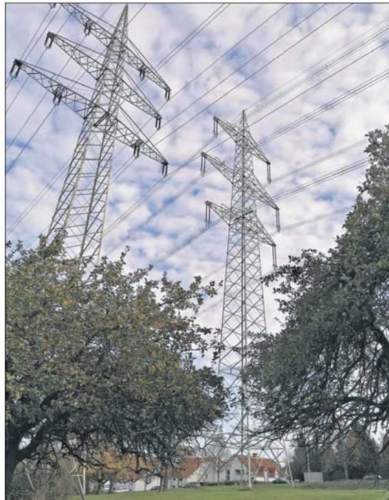
Unmittelbar neben dem Hessenring verläuft die bestehende Stromtrasse. Foto: bpa
