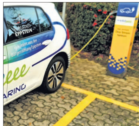
Der städtische Dienstwagen an der Ladesäule vor dem Rathaus in Vockenhausen.
