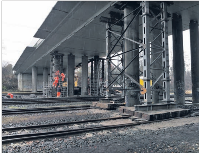
Die marode Straßenbrücke über die Bahngleise in Niedernhausen soll Mitte des Jahres abgerissen werden. Foto: Hessen Mobil
