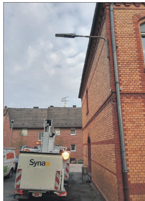
Eine neue LED-Leuchten sorgt am Alten Rathaus für bessere Beleuchtung. Foto: privat
