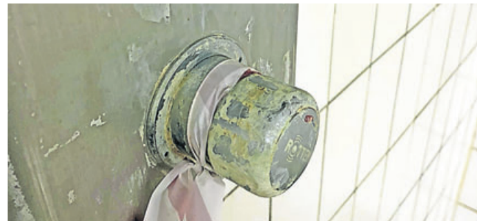
Die verkalkten Armaturen in den Duschräumen der Frauenwaldhalle.
