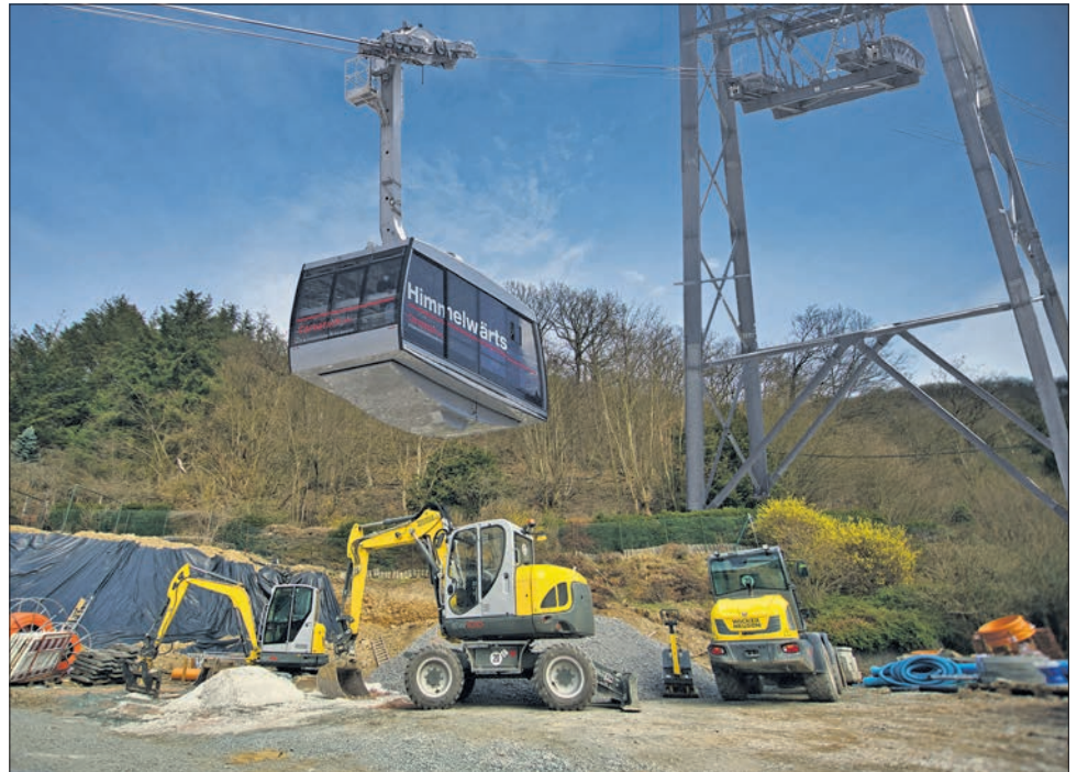
Eine Seilbahn auf den Staufen über der Gimbacher Straße in Eppstein.
