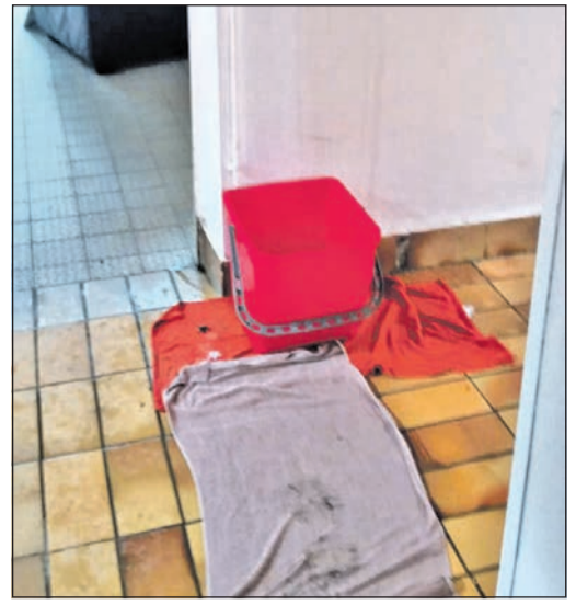
Mit Eimern und Lappen wird das eindringende Wasser im Verwaltungsgebäude aufgefangen. Foto: Verein Tierheim
