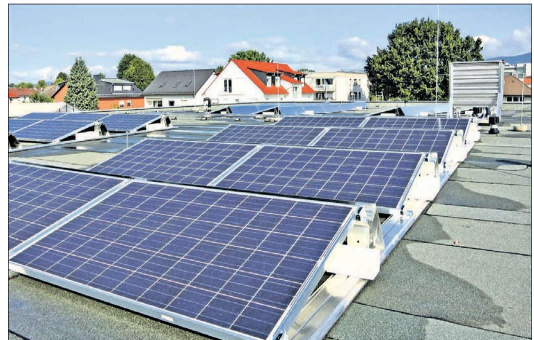
Seit dem 1. Januar fördert die Stadt erstmals private Solarstrom-Dachanlagen, Stromspeicher und häusliche Ladestationen für Elektroautos. Foto: Stadt Eschborn
