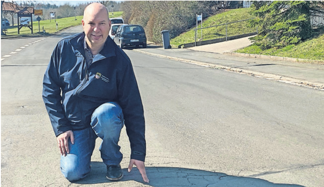
Kreisbeigeordneter Matthias Walther freut sich, dass im Rahmen der Straßenbauprojekte auch die Fahrbahnschäden auf der K 217 in der Ortsdurchfahrt Gelnhaar bald beseitigt werden.
