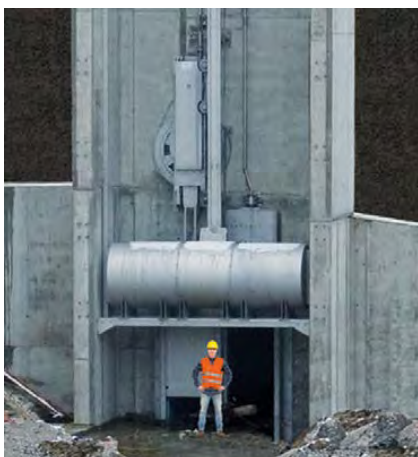
Mechanische Abflusssteuerung HydroMaxx – Hochwasserrückhalt am Sulzberger Bach
