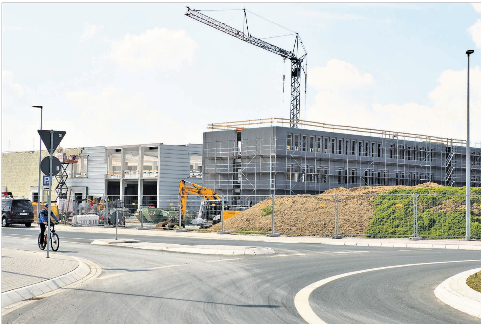
Die axicorp GmbH baut gegenüber ihrem derzeitigen Firmensitz eine neue Produktionsstätte mit Lager und Verwaltung im neuen Gewerbegebiet Friedrichsdorf. Foto: fch
