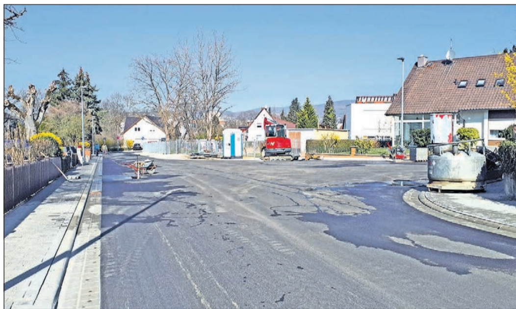
Die Bauarbeiten in der Höchster und Schwanheimer Straße sind weitestgehend und wie geplant abgeschlossen. Foto: Stadt Schwalbach
