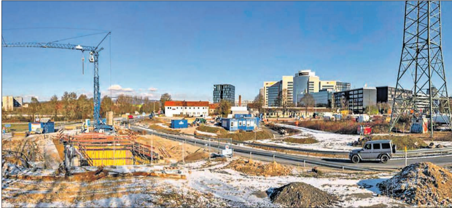
Auf der Großbaustelle an der A66 zur Düsseldorfer Straße werden jetzt im Endspurt alle Kräfte mobilisiert.
