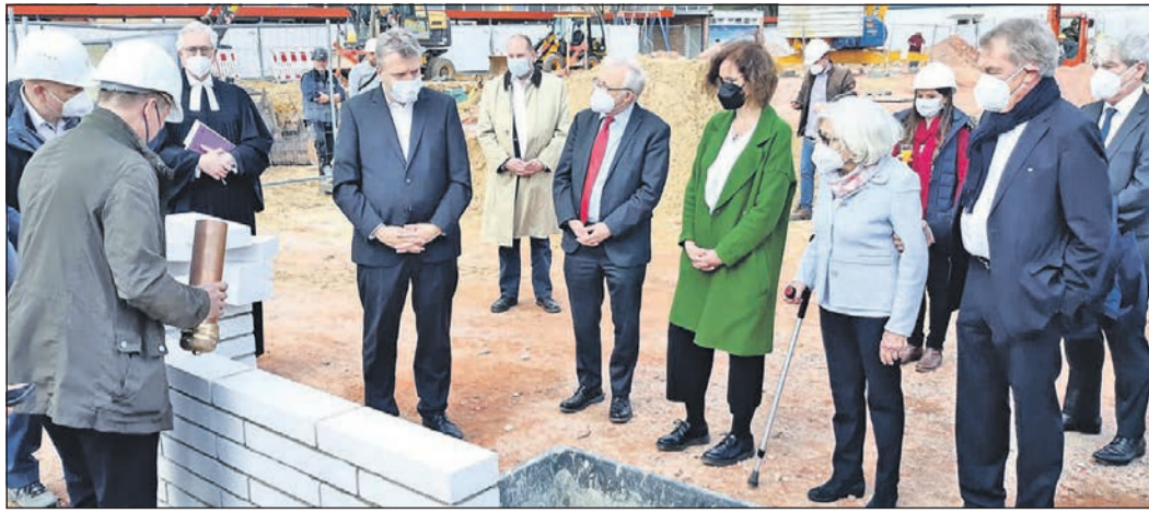
Grundsteinlegung in großer Besetzung: Außer den Männern vom Bau (links) nehmen daran unter anderen Pfarrer Reiner Göpfert, Landrat Ulrich Krebs, Erster Kreisbeigeordnete Thorsten Schorr, Oberursels Bürgermeister Hans-Georg Brum, Schulleiterin Susanne Zobel-Unruh und der Stiftungsvorstand der Hans-Magiera-Stiftung mit Gisela Magiera, Uwe Flach und Clemens Schallast (vordere Reihe v. l.) teil. Foto: js
