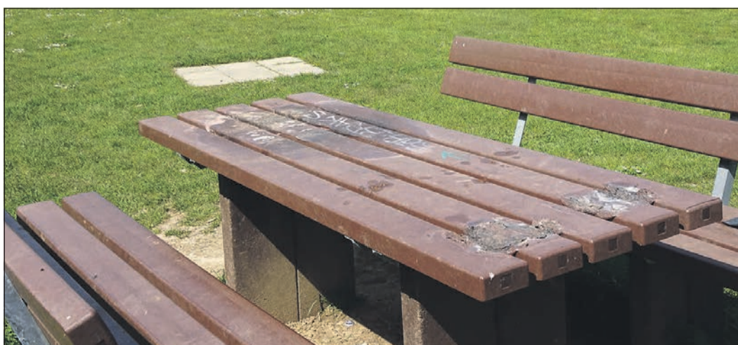
Beschmierte und beschädigte Sitzgruppe auf dem Bolzplatz im Wingertsgrund.
