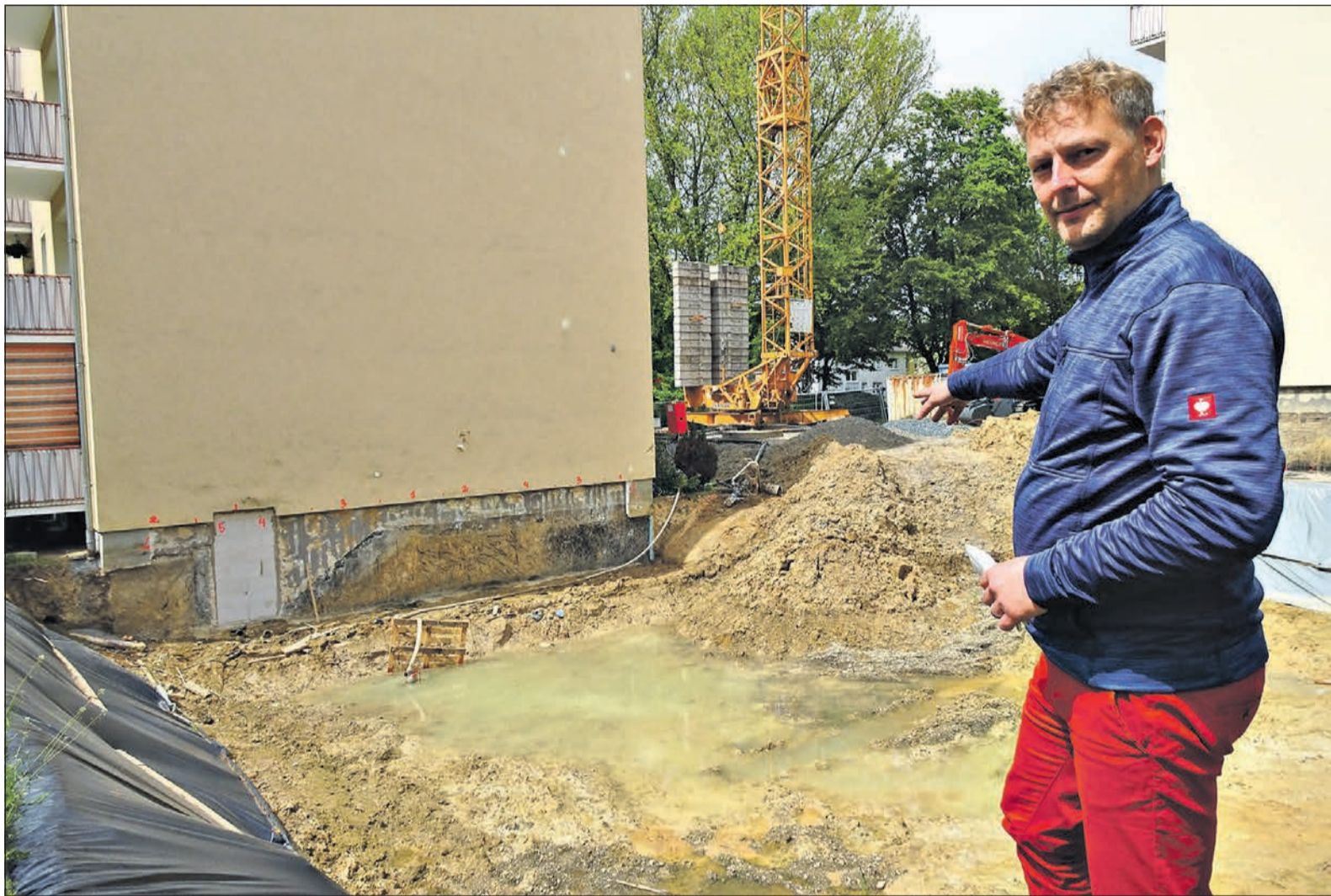
Niki Schuster, Projektbetreuer des Bauherrn, an der noch mit Wasser gefüllten Baugrube am Hessenring, an der nun die Pumpen in Aktion treten. Bis Ende nächsten Jahres sollen hier unter der Regie des VBS nicht nur 15 Seniorenwohnungen entstehen, sondern auch eine Tagespflege und ein Café das Leben im Quartier bereichern. Foto: HB
