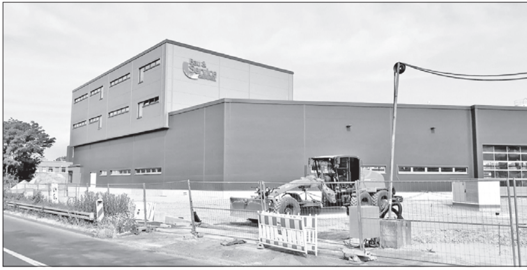
Ebenso wie Energielieferant Stadtwerke soll auch der BSO als Vorbild vorangehen. Sein neues Betriebsgebäude wurde wie eine Trutzburg in die Landschaft bei Weißkirchen gesetzt. Foto: js
