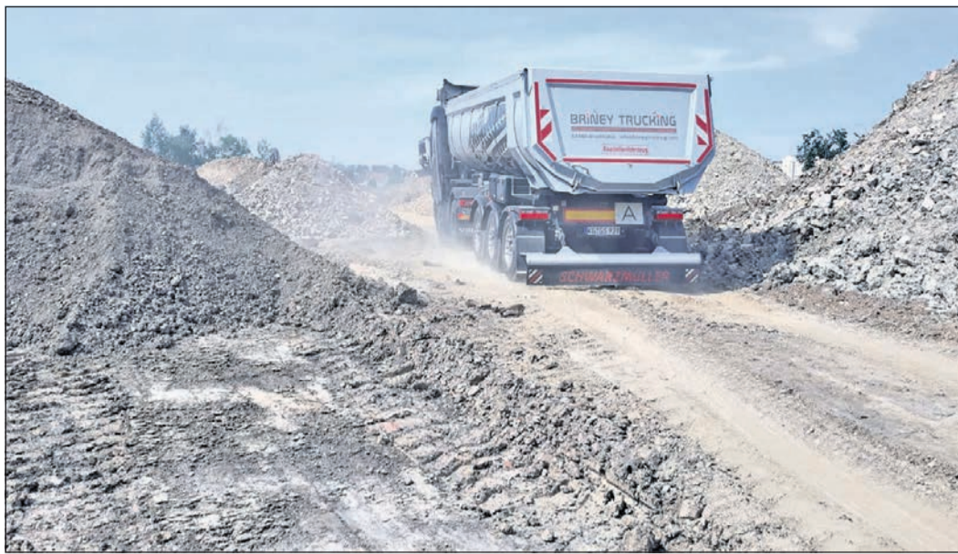
An der „Neumühle“ türmen sich Erdhaufen und Gesteinsbrocken in Kegeln gen Himmel. Ständiger Liefer- und Abholverkehr mit Schwerlastern produziert staubige Luft. Foto: js
