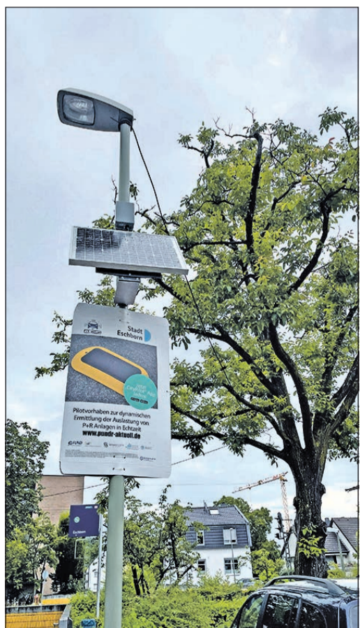
Solarmodule versorgen das Gateway mit Strom, das dann die Informationen der Parkplatzbelegung an die zentrale Datenplattform weiterleitet. Foto: Stadt Eschborn
