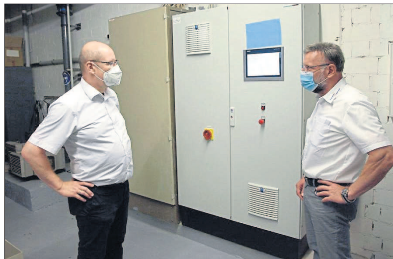
Jörg Gräf erläutert Bernhard Kurz die neue Technik, hier die neue Steuerung.
