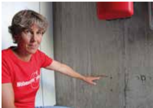
Das FreibadSoden war stark vom Hochwasser betroffen. Freibad-Chefin Katja Gilcher zeigt, bis wo das Wasser im Technikkeller stand.
