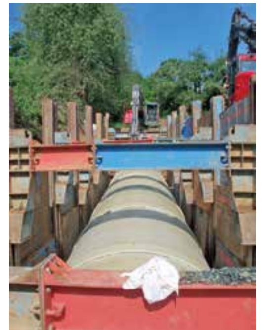
Das unterirdische Regenrückhaltebecken (RRB) Großer Hetzel.
