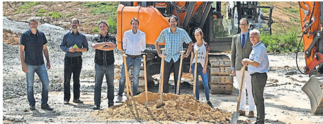
Frank Volmer (Amtsleiter Gebäudemanagement), Alexander Sust (Umweltzentrum Fulda), Torsten Fell (Gebäudemanagement), Stephan Koch (Architekt Büro K2), Simon Wingenfeld und Daniela Kutscher (Firma Wingenfeld), Stadtbaurat Daniel Schreiner sowie Marcus Schlag (Geschäftsführer LGS-Gesellschaft) (vion links).
